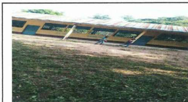
Foto 3: Se observa puertas óxidado
