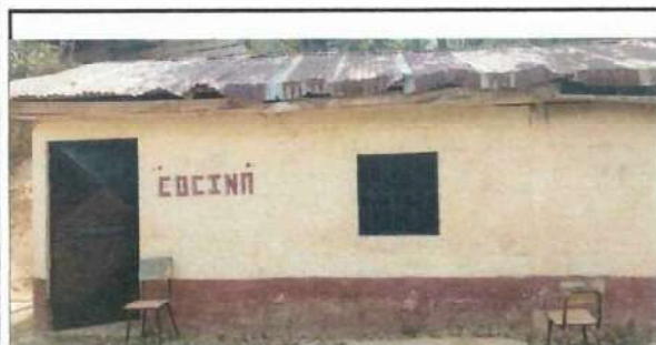
Foto 5: Se observa las láminas deteriorado
