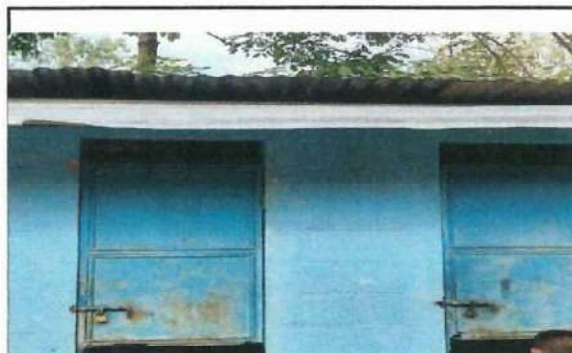
Foto 4: Se observa las puertas del baño perforado por óxido
