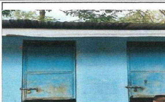
Foto 2: Se observa techo del baño con goteras
